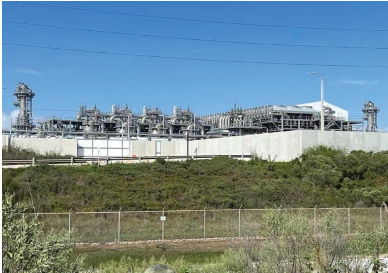
Figure 6.5. Trains at Freeport LNG
